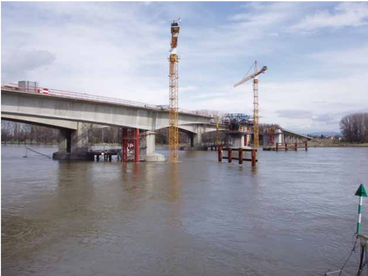
Abb. 1: Im März 2007 war der Bau der neuen Rheinbrücke schon recht weit fortgeschritten. Es fehlte aber noch der Schluss von zwei Lücken. Der Betrieb der Rheingütestation wurde vom Bau nicht beeinträchtigt.
