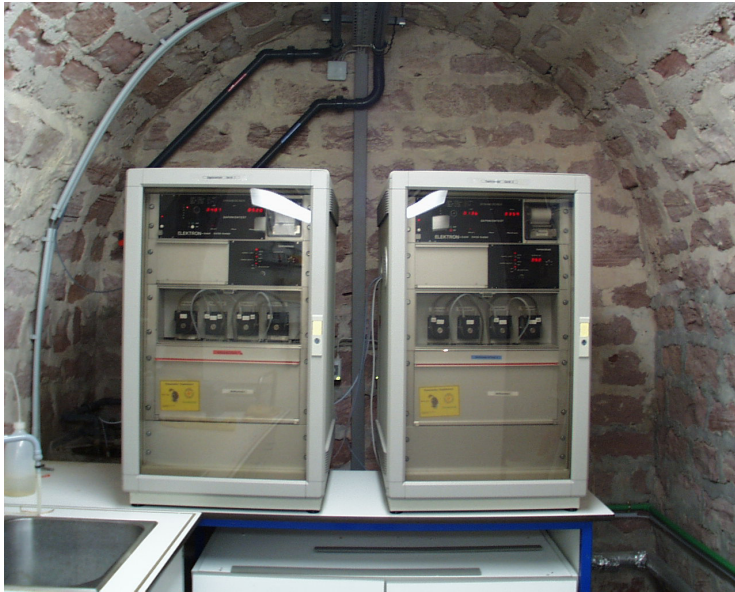
Abb. 1.3.11: Die zwei Dynamischen Daphnientests (Fa. Elektron) der Rheingütestation Worms an ihrem Standort im Gewölbe.
